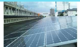
太陽光発電所（宇多津駅）
